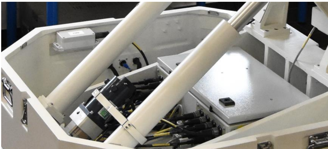
Рисунок 1.2.3.1 - Внешний вид блока БСН установленного на антенне
